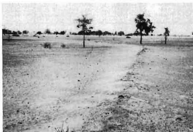
5 — Dégradation d'un aménagement antiérosif de versant (Sabouna — nord de Ouahigouya). Matériau sableux poussé à l'ouest (à gauche) du bourrelet.
