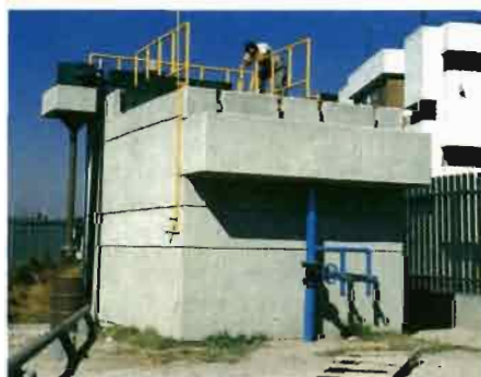
Réacteur UASB pilote de 50m 3 UAM1 pour le traitement des eaux usées urbaines Mexico - photo JP. Guyot
