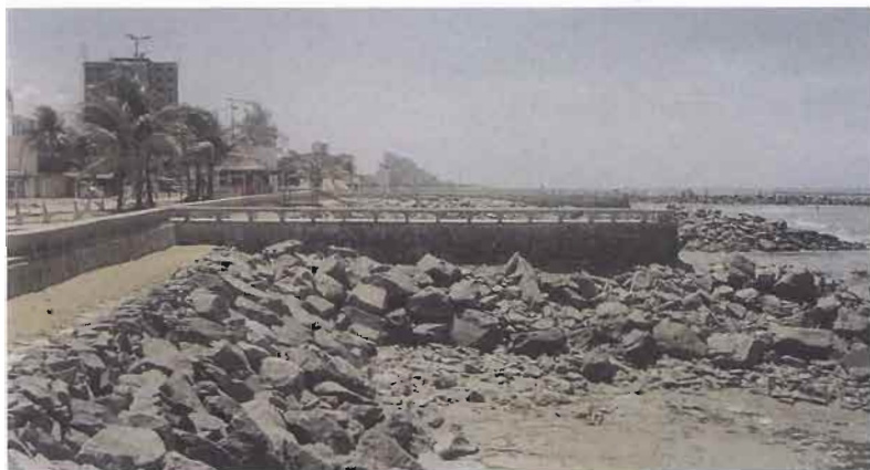
Figura 4 – Orla de Olinda, Avenida Senador Marcos Freire, onde se podem notar as obras de contenção do avanço do mar onde outrora existiam os bares que foram transferidos para o lado esquerdo da avenida.
