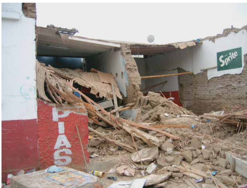
Figura 2 – Destrucción de una construcción de adobe en Chincha Alta
