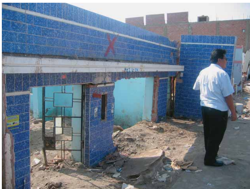
Figura 3 – Destrucciones en el distrito de Tambo de Mora (las casas se han desplomado debido a fenómenos de licuefacción del suelo)
