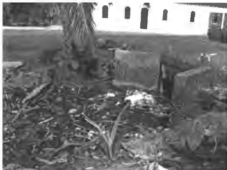
Figure 5 Exutoire d'eaux usées à Falaleu.
