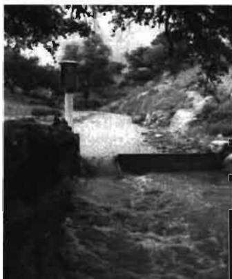
Figura 3. Pequeña obra de aforo hidrológico.
