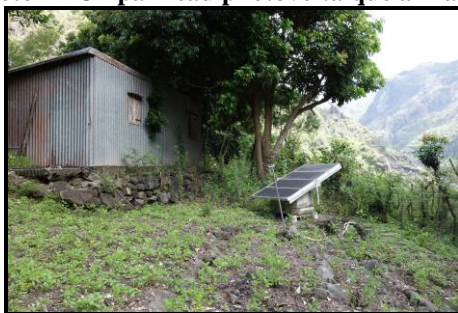
Photo 2 - Un panneau photovoltaïque à Mafate
