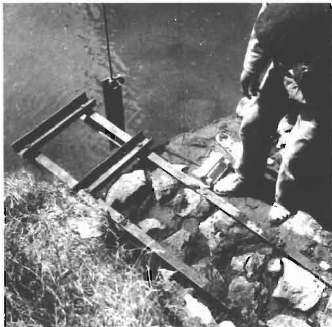
Photo n° 9 Scellement des U P N devant supporter le tube du limnigraphe de l'Andromba
