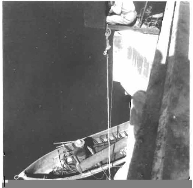
Photo n° 2 Installation d'un limnigraphe Richard sur une pile de pont (Ikopa à Anosizato).
