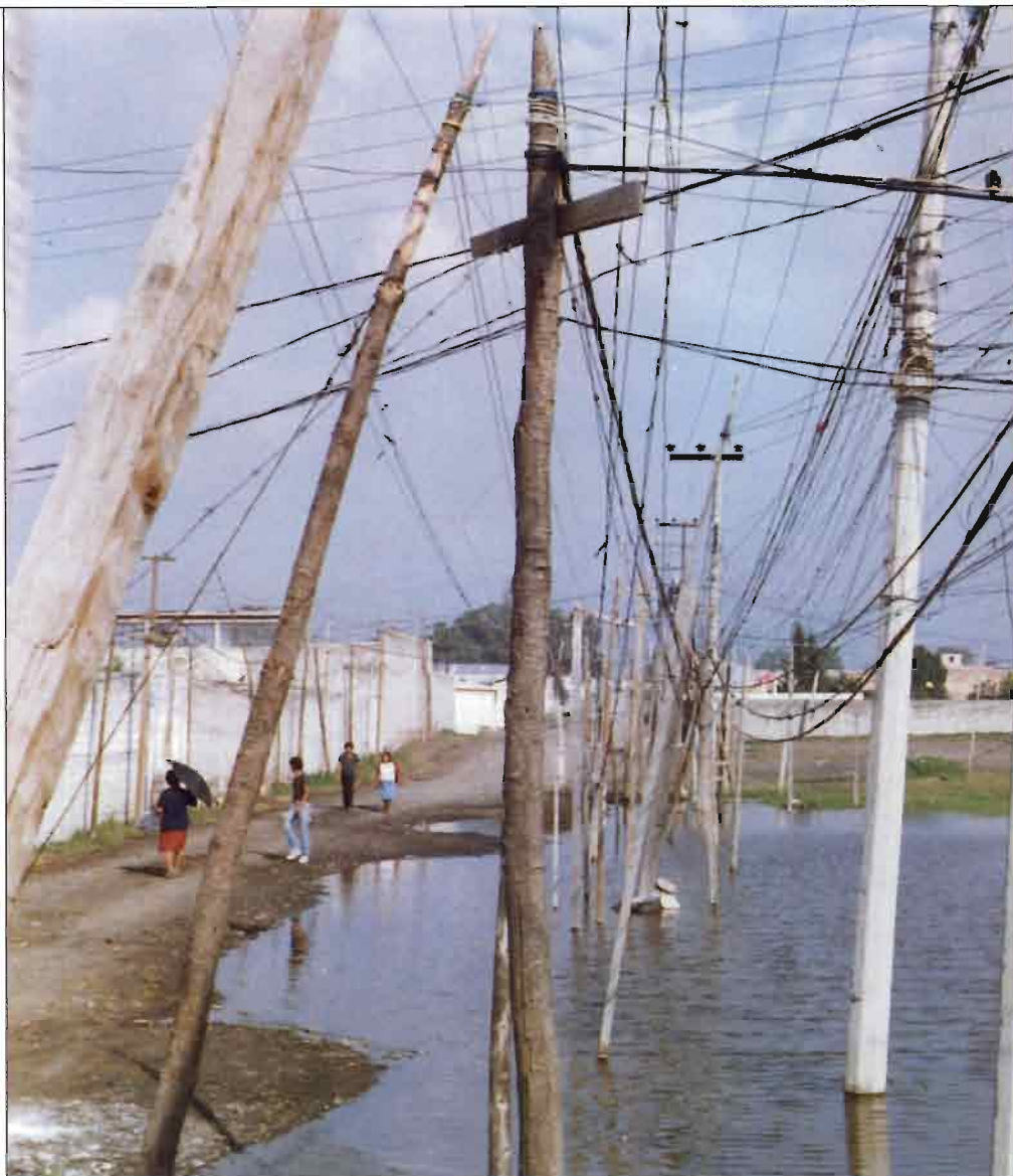
Lignes électriques pirates, situation aujourd'hui régularisée - Photo : Bernard Lacombe
