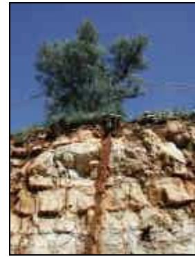
Fissures dans les couches calcaires (Nahr Beyrouth)
