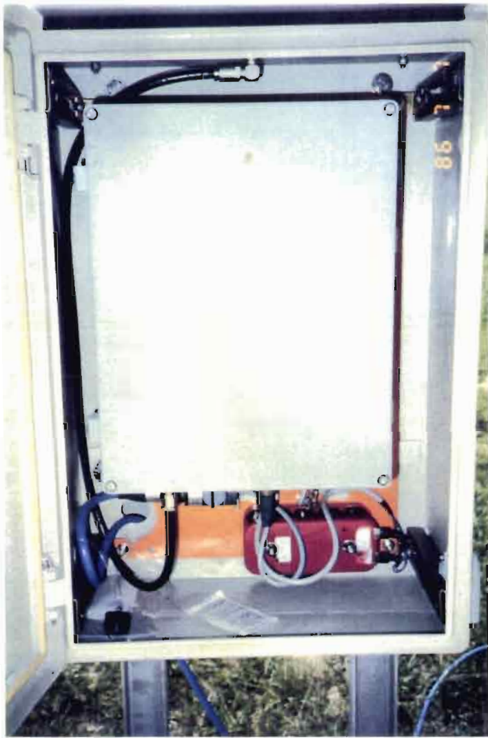
Vue de l'intérieur après ouverture du premier coffret abri
