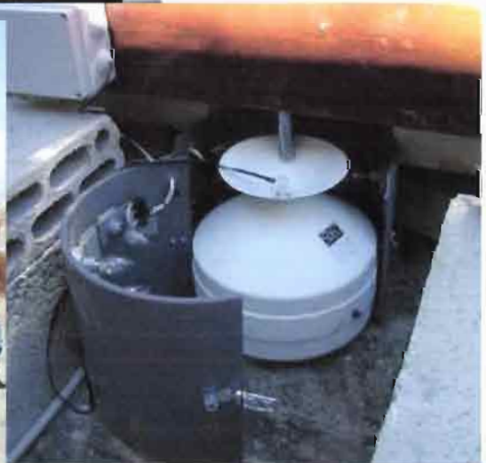
Dispositif de chauffage externe du pluviomètre
