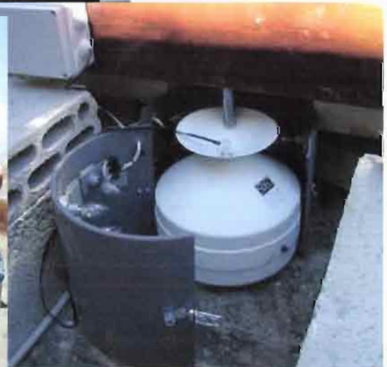
Dispositif de chauffage externe du pluviomètre
