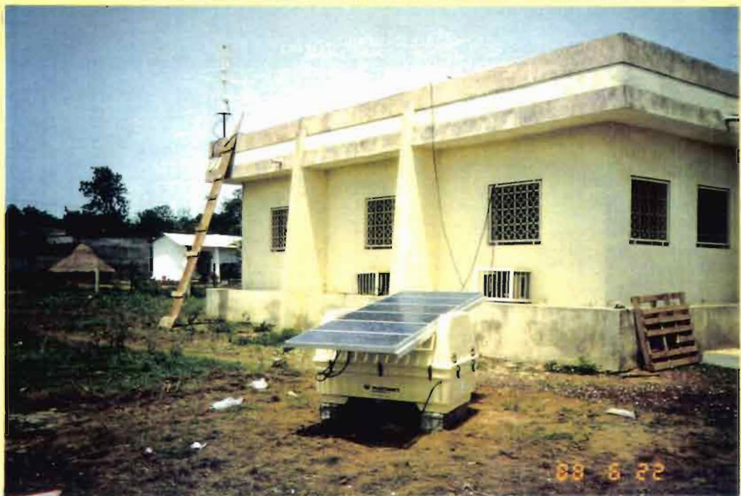
VUE GENERALE DE L'ALIMENTATION SOLAIRE
