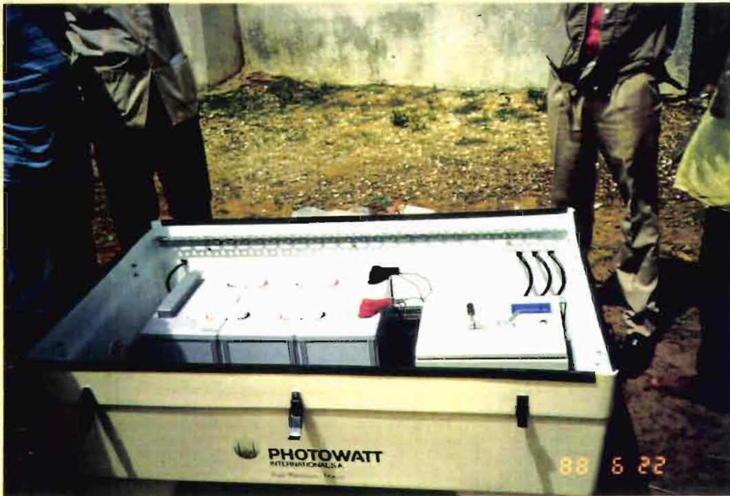
BATTERIES ET REGULATEUR
