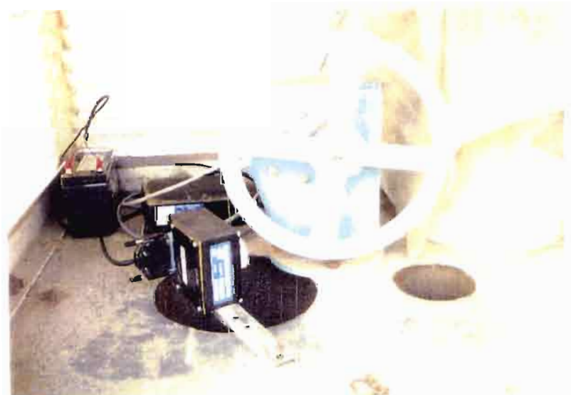
Le codeur installé
