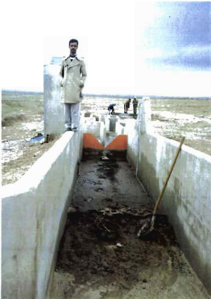
Les premières mesures de transport solide et d'érosion à CHAFAI 2 le 17 Novembre 1992
