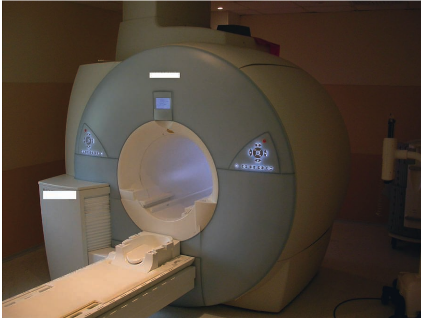
1. IRM. Appareil d'imagerie par résonance magnétique de 1,5 tesla. Noter au-dessus de l'aimant, la présence d'un conduit qui, en cas de quench, sert à l'évacuation de l'hélium gazeux à l'extérieur de la salle d'examen.
