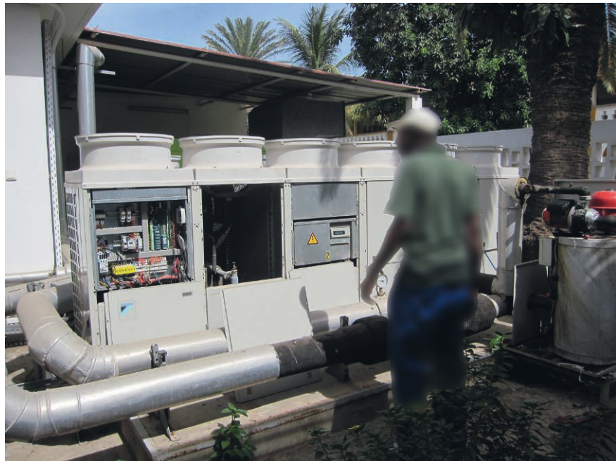
3. Le groupe de froid n°1 en cours de maintenance. Chaque groupe comprend trois modules équipés chacun d'un compresseur et d'un ventilateur.
