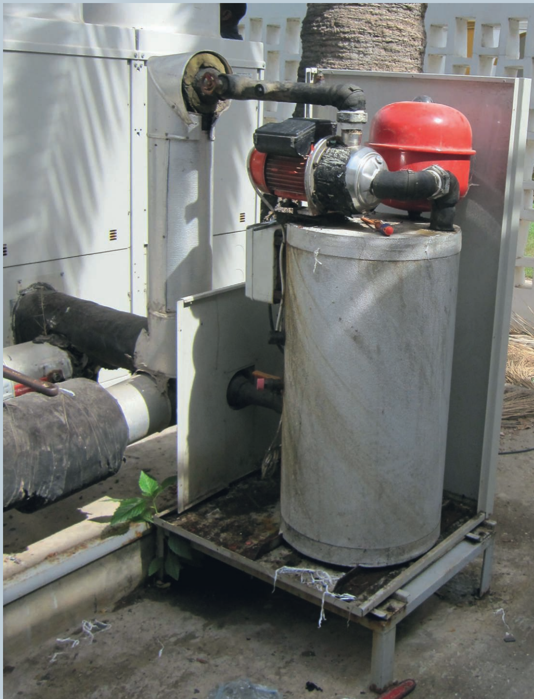
4. La pompe du groupe de froid n°2 (cannibalisée sur le groupe n°1) telle qu'elle apparaissait en décembre 2012, six mois avant que ce groupe ne tombe définitivement en panne.
