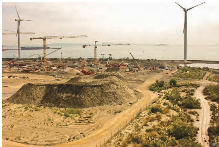
Figure 7a. Aménagements anthropiques du grand port maritime de Marseille. (Crédits: Teddy Baumberger.)
