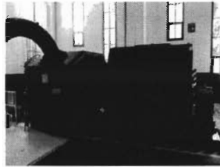
Annexe 18 : Unité de production (Centrale Cuticucho-Vallée Zongo)
