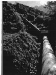
Annexe 10 : Tuyau d'adduction d'eau (centrale Chojlla)
