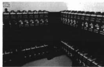
Annexe 21 : Batteries destinées à faire redémarrer les centrales en cas de panne (Centrale Cuticucho-Vallée Zongo)
