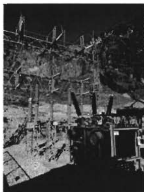
Annexe 13 : Transformateur de la centrale Zongo
