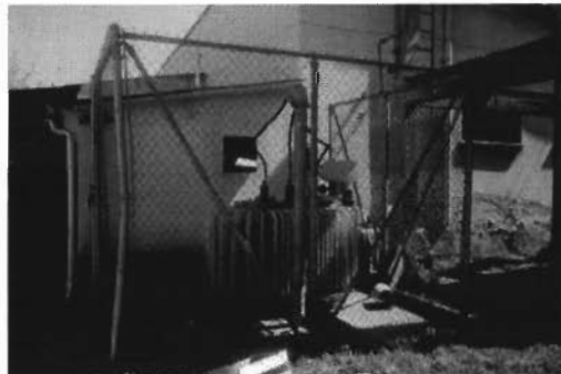
Annexe 28 : Exemple de générateur d'appoint (Hôpital Général-La Paz)
