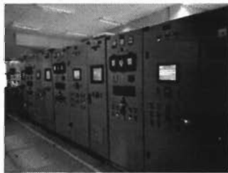
Annexe 20 : Poste de contrôle (Centrale Cuticucho-Vallée Zongo)
