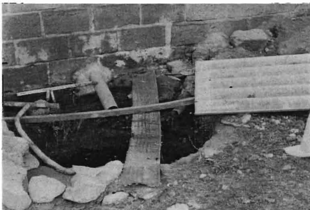
Photo. 9: Puisard creusé à même le sol, collectant les eaux de toilette et de faibles quantités d'eaux de pluie.
