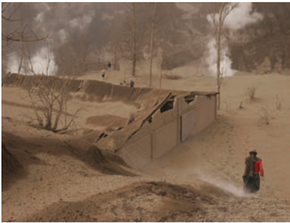
Granja avícola con el techo colapsado bajo el peso de las cenizas y escoria del volcán Tungurahua, 2006.
