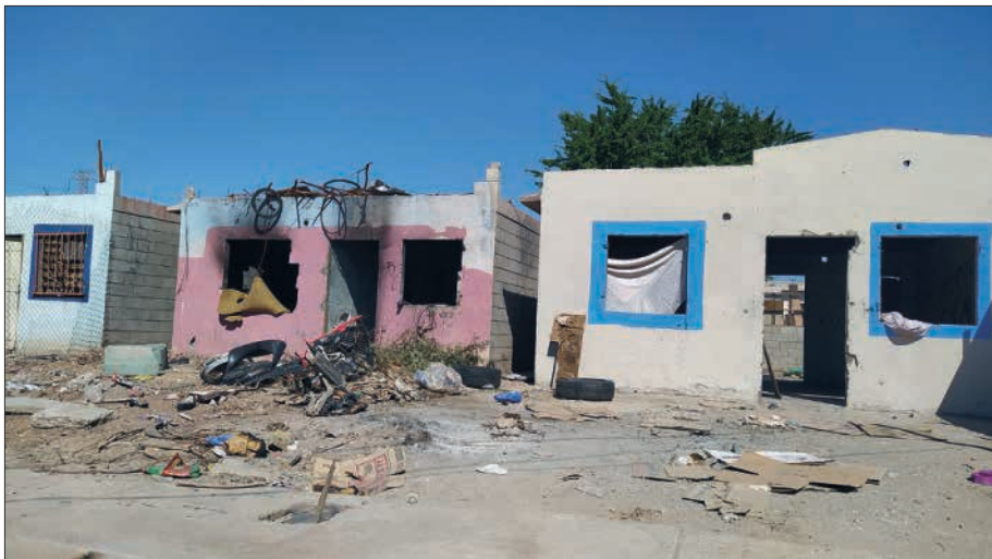
Fig. 5. Logements abandonnés, vandalisés et incendiés dans le secteur Valle de Puebla, à Mexicali. Un paysage ordinaire dans les périphéries d'habitat social de cette ville frontalière avec les États-Unis.
