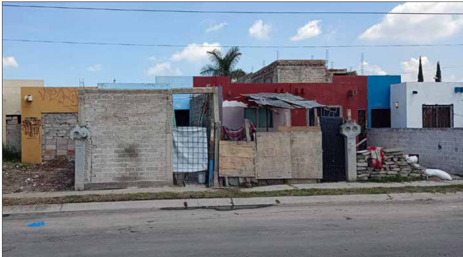
Fig. 4. Transformations précaires du bâti et logements abandonnés, pillés et murés dans un ensemble d'habitat social à Tlajomulco, en grande périphérie de la ville de Guadalajara.
