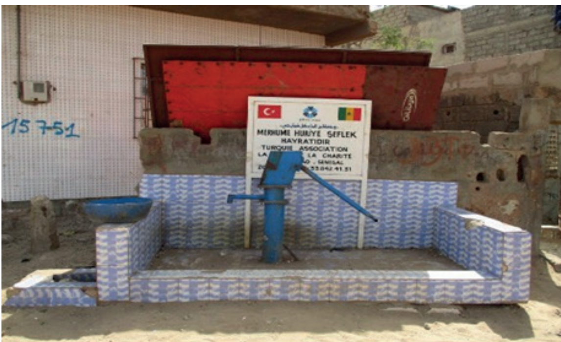
Photo 9- Pompe djambar abandonnée au quartier Doubaless, Yeumbeul Sud
