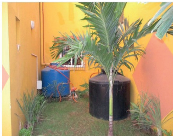
Photo 7- Pompe électrique raccordée à réservoir, Résidences Hacienda, Dalifort
