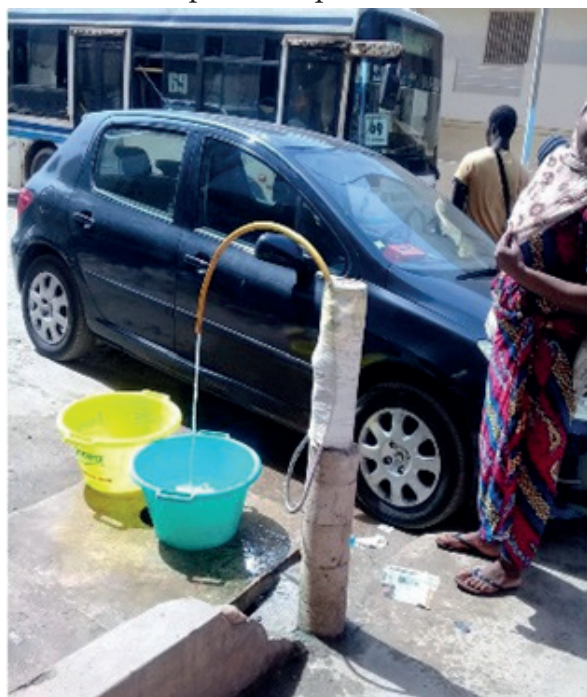
Photo 6 - Pompe électrique, Unité 13 des Parcelles Assainies
