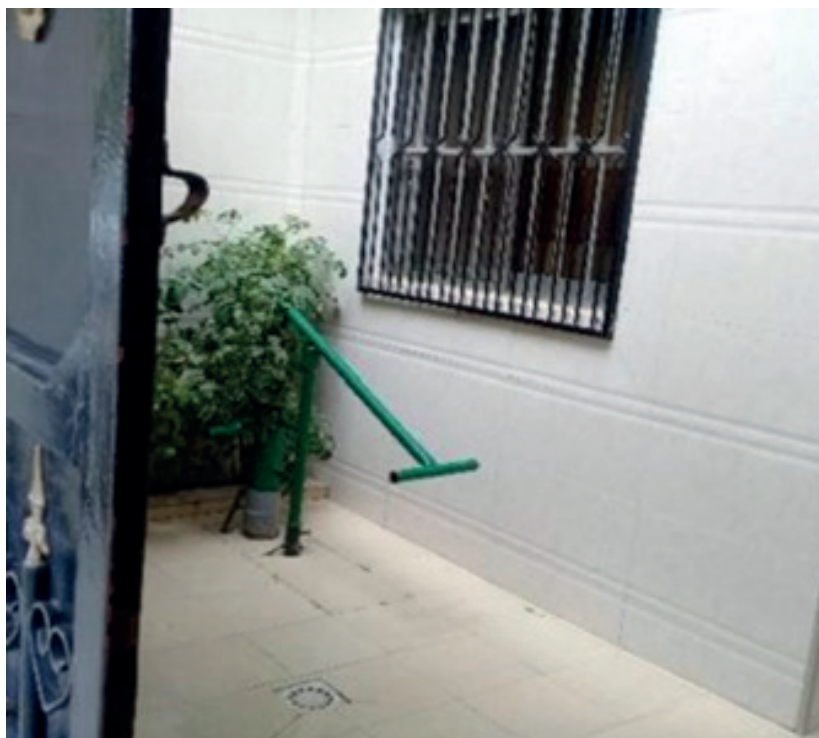
Photo 3- Pompe djamba dans une cour de maison à Hann Maristes 2
