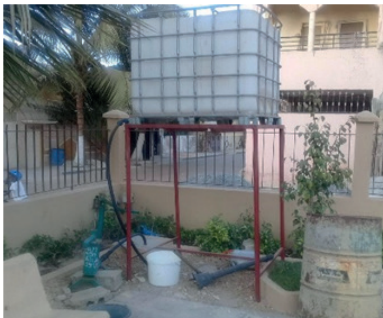
Photo 4 : Pompe djambar raccordée à un réservoir dans le jardin des Résidences Hacienda, Dalifort
