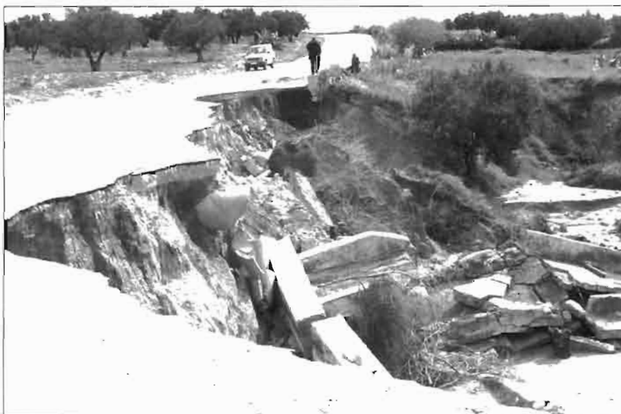
Photo 3. Infrastructure routière endommagée par une crue en Tunisie centrale (septembre 1995).
