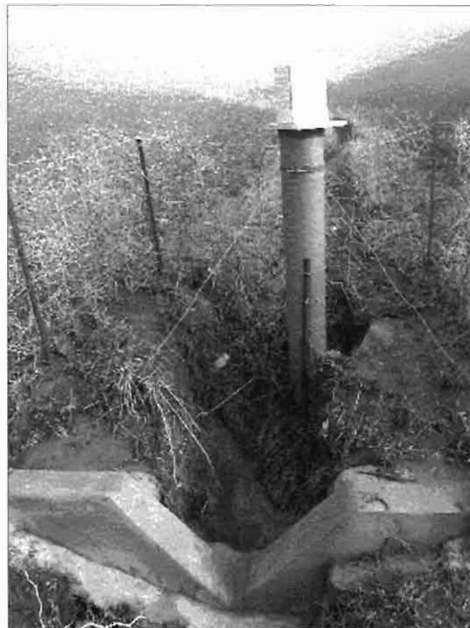
Figure 5. Vue du déversoir comblé par les apports détritiques de la crue du 24-25 décembre 2002.
