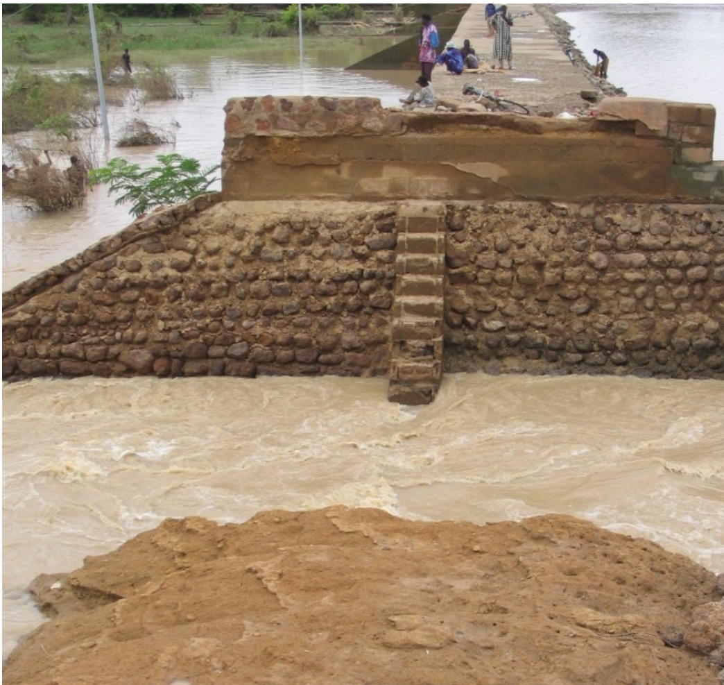
Figure 7 Brèche ouverte par la crue du 11 juillet dans la digue du réservoir du Monastère de Koubri (cliché N. Augis, IRD).
