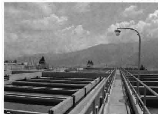
PLANTA DE TRATAMIENTO DE AGUA
