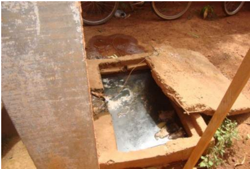
Figure 1. 11 : Eaux usées de la mosquée de l'université déversées dans un canal mal étanchéifié.
