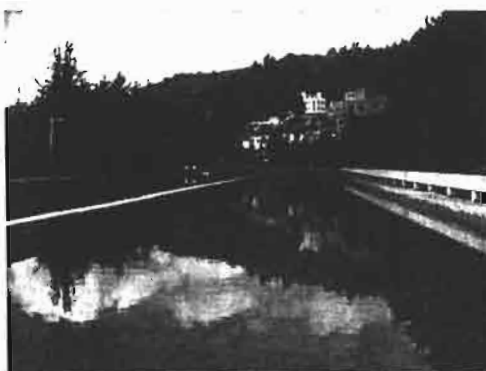
Figura 22: Los dos sedimentadores de la planta de tratamiento Achachicala. Enero de 2009
