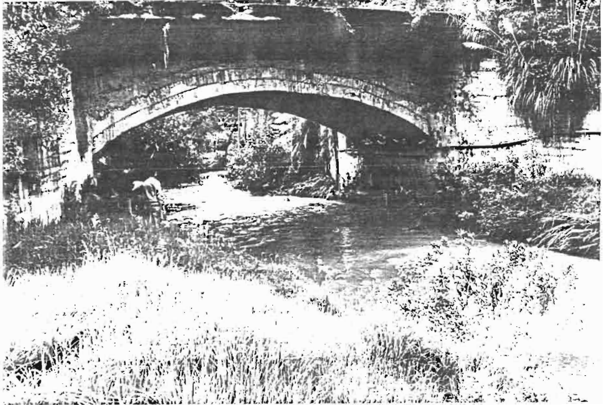
EL 28 DE MAYO EL RIO SUBIO HASTA LA MANGUERA QUE SE VE EN LA PILA DERECHA ENCIMA DE LAS PLANCHAS LIMNIMETRICAS
