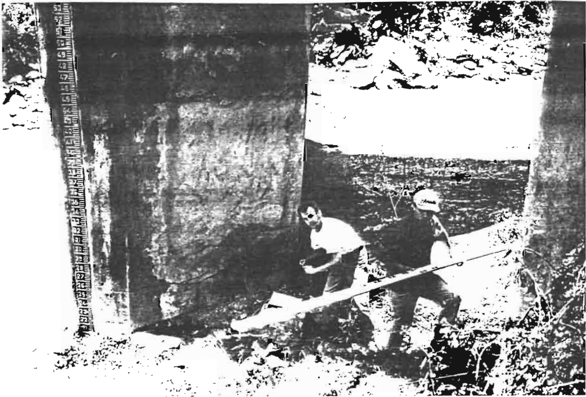
TORRE LIMNIGRAFICA FISURADA
