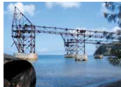
Wharf à l'abandon de l'ancienne mine de Goro (Yaté), appelée « mine des Japonais ». © J.-C. Gay
