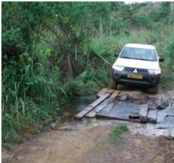
Photo 4 : Guet sur la route de Moukomo, toujours en mauvais état
