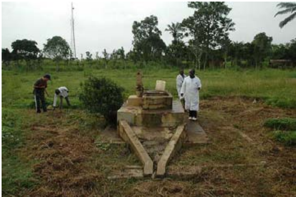
Photo 16 : La source d'eau du CSI de Kingoué, dont la pompe ne fonctionne plus Territoires sanitaires
