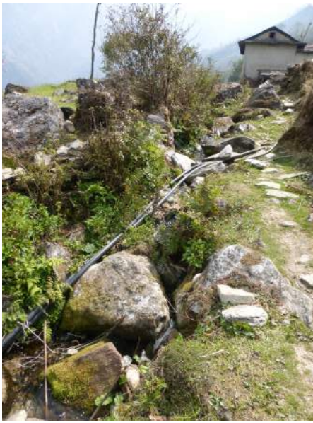
(a) Conduite d'acheminement.
