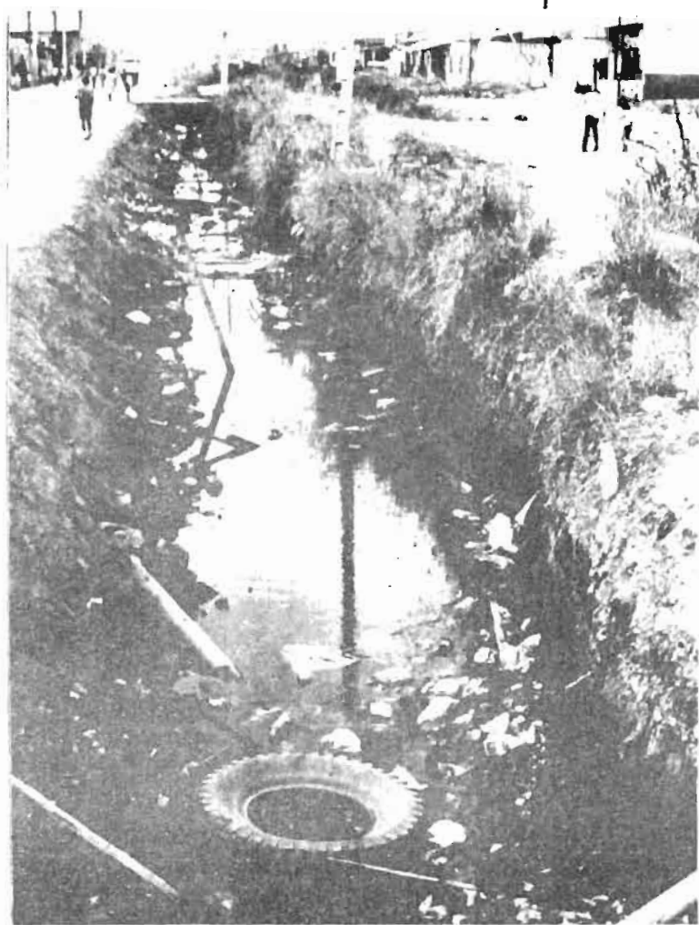
Foto 18 El Guasmo: relleno de las calles pero ausencia de alcantarilla (foto H. R. GODARD).
