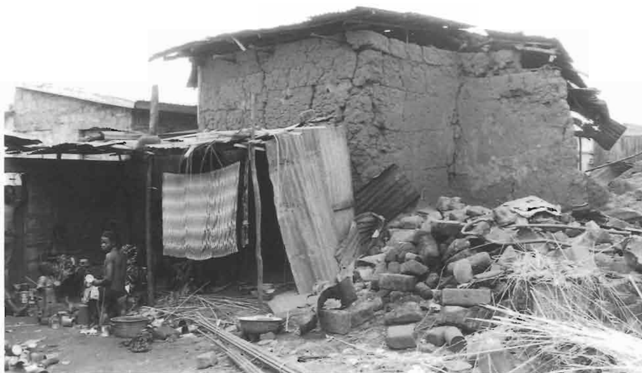
Différents aspects de la dégradation des bâtiments.
