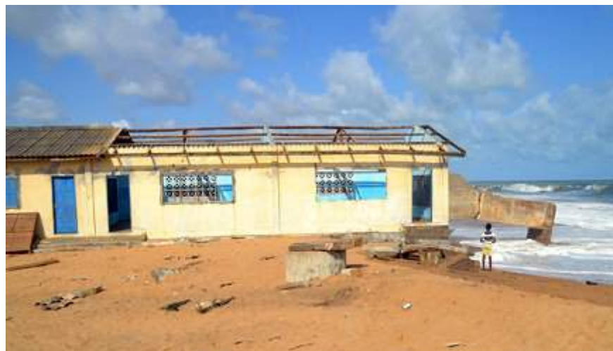
Figure 8 : Photo de l'école primaire publique de ENAGNON après la tempête du 24 Avril 2016 dans le secteur de la zone d'étude
