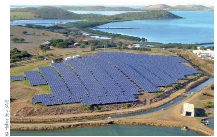
Centrale photovoltaïque d'Helios Bay
