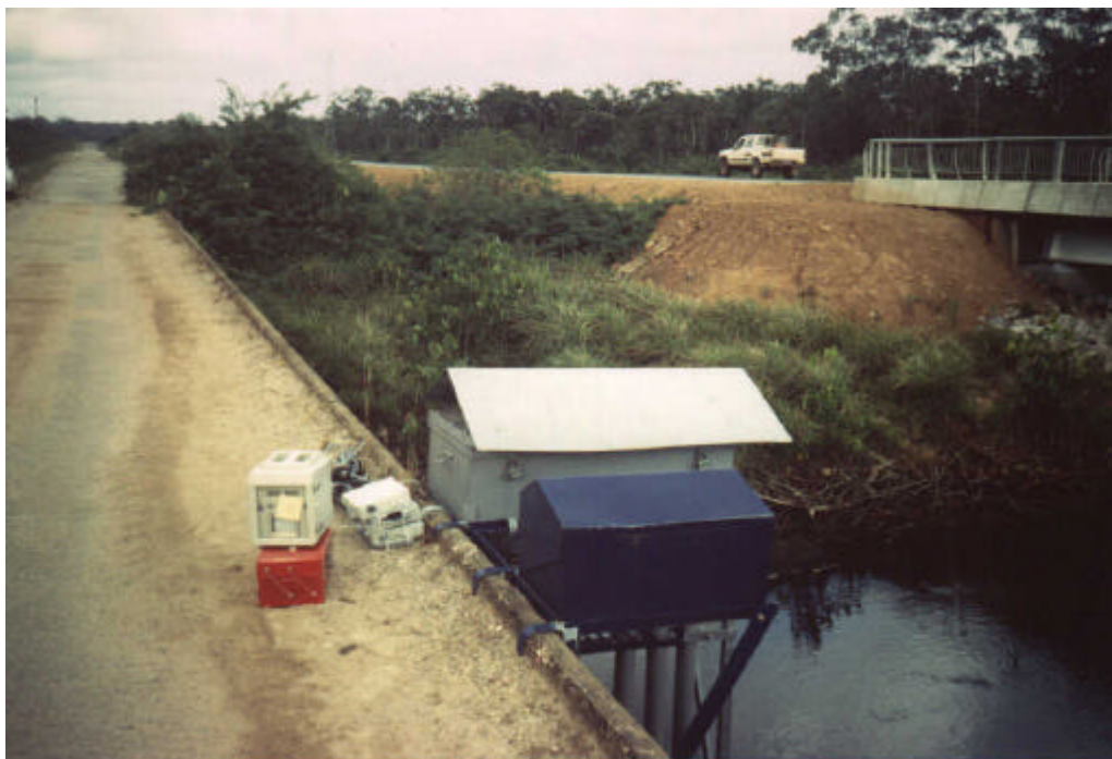
Station limnimétrique de la Passoura au pont RN1
