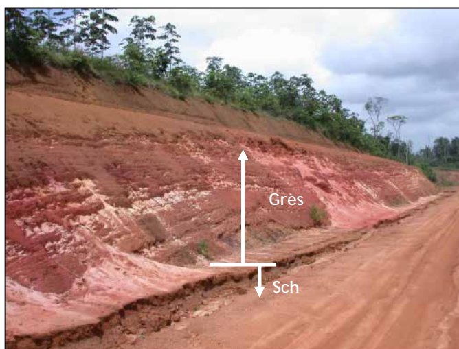
Fig.16 : Erosion des versants de talus de travaux des pistes dans les sols sur grès rouge et jaune, associés aux schistes du Bonidoro (Sch). Grande piste Saint Laurent - Apatou, Commune d'Apatou, Photo M. Brossard
