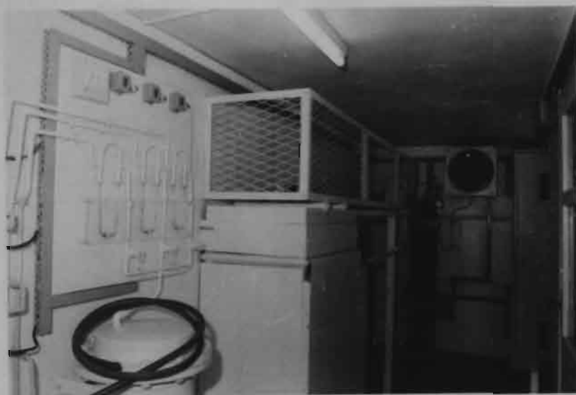
Pour protéger le couloir d'entrée de toutes vapeurs nocives, le ventilateur (au fond de la photo) est mis en marche par l'ouverture de la porte d'accès à la salle d'attaques.
