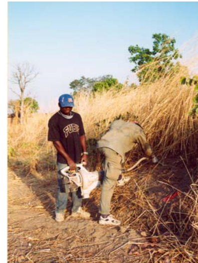
Terrier le long d'une digue en zone de cultures à Diéra
