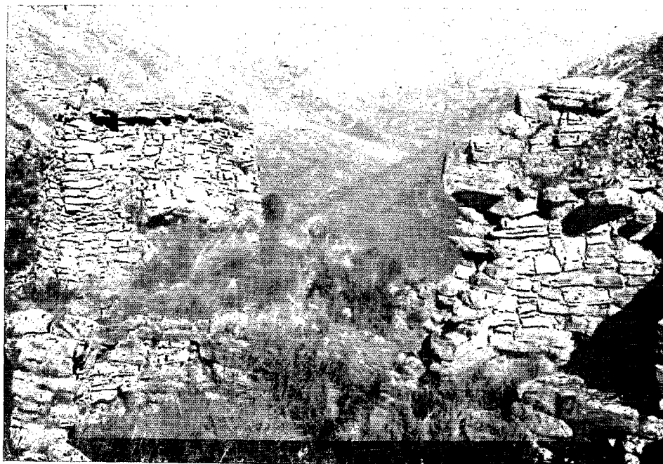
a : RAKASMARKA, deux constructions à deux étages du secteur est (dir. nord)
