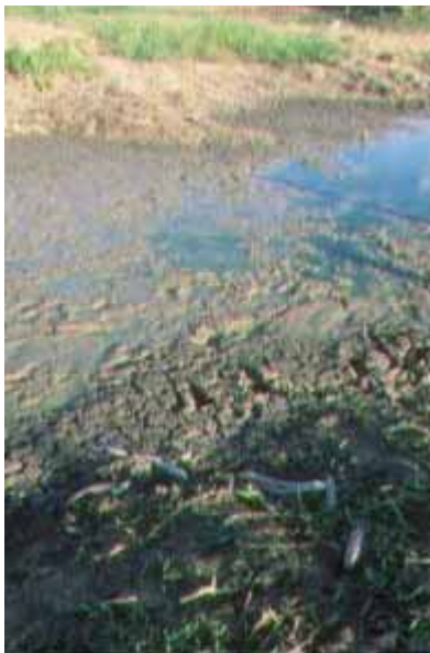
Foto 19. Aspecto superficial do solo fissurado do centro do açude.
