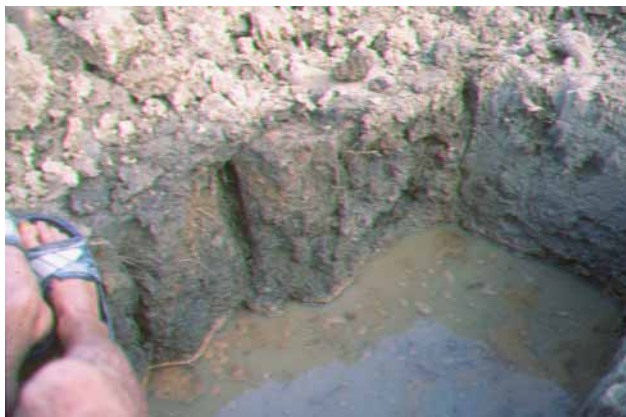
Foto 20. Perfil de solo fissurado no centro do açude.
